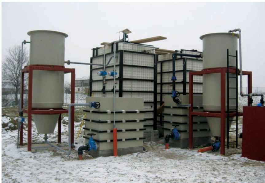
Probna postrojenja za pročišćavanje
