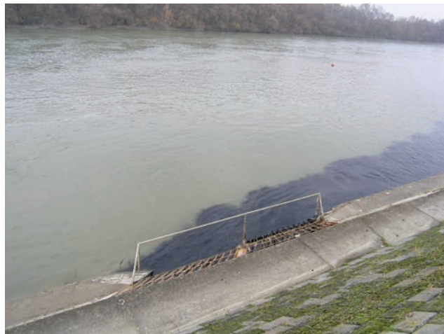
Sadašnji ispusť otpadnih voda u rijeku Dravu
