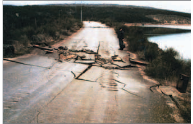
Uleknuće krune na najvišem dijelu brane
