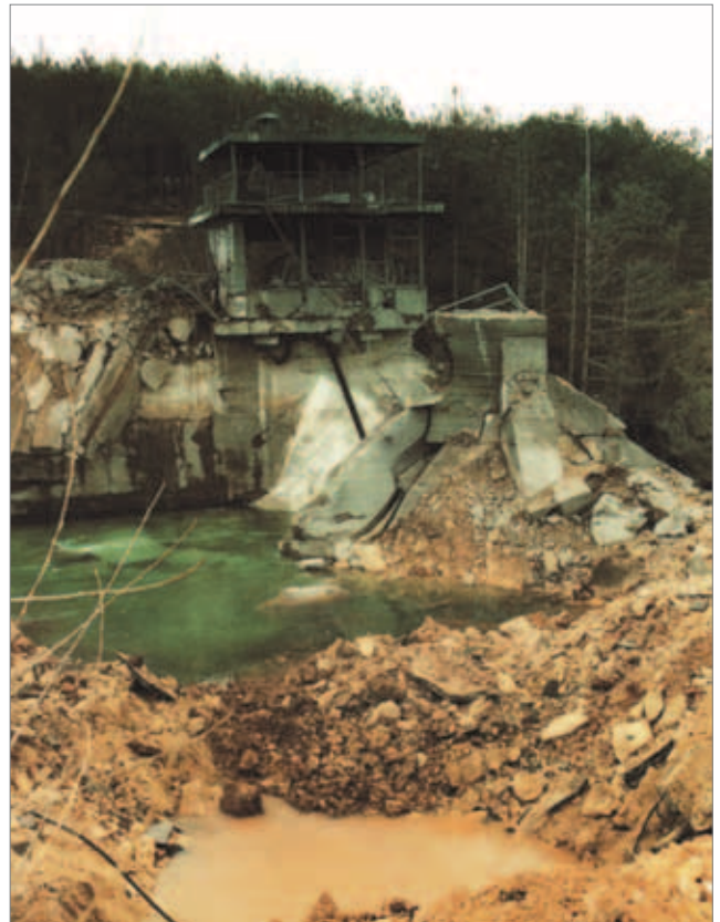
Iz oštećenja na lijevom kraju brane voda je otjecala u injekcijsku galeriju
