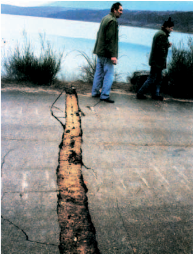
Poprečna pukotina na asfaltu u kruni brane
