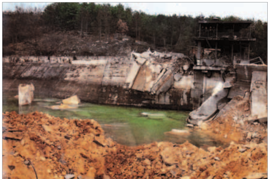
Najteža oštećenja na lijevom kraju brane
