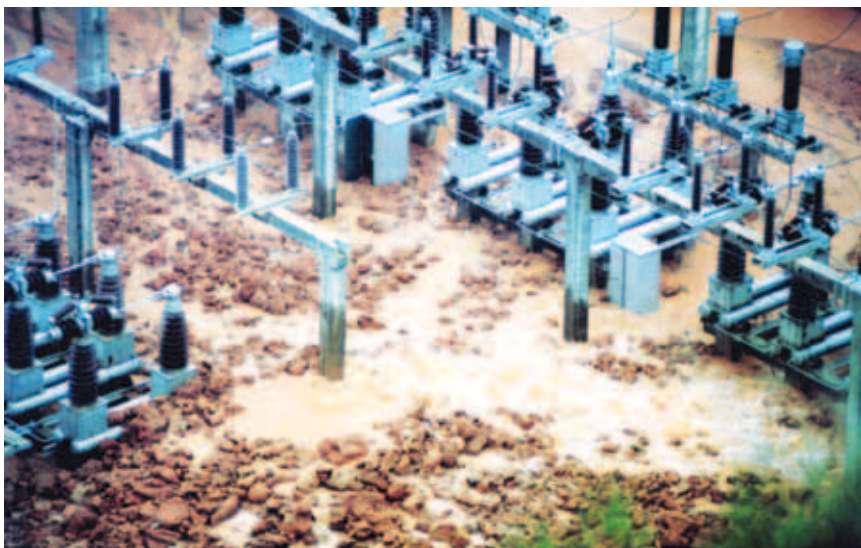
Poplavljeno rasklopno postrojenje
