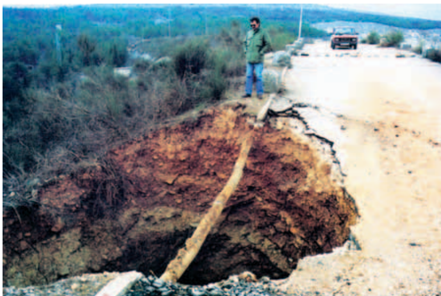
Kaverna na nizvodnom dijelu brane otvorena 4. ožujka 1993.
