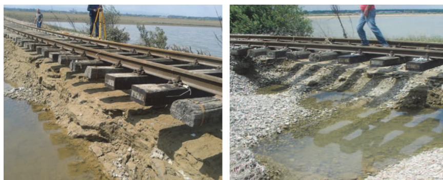
Slika 3. Stanje gornjega pružnog ustroja nakon poplave na dionici željezničke pruge R105 Vinkovci – Drenovci – državna granica [17]
