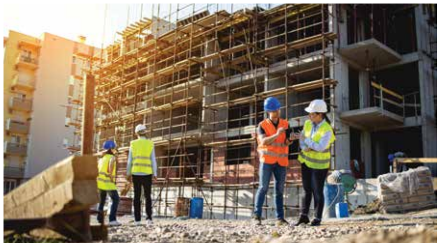
Velik porast cijena građevnoga materijala stvorio je ozbiljne probleme na tržištu (izvor: https://d3cl79h6n1fe0x.cloudfront.net/ )
