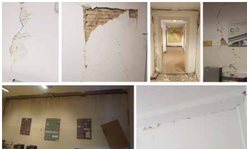
Oštećenja zgrada AGG fakulteta u Kačićevoj ulici
