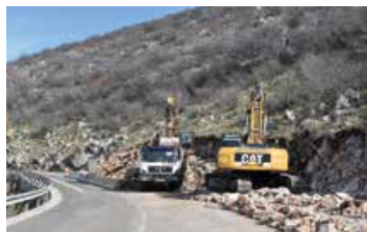
Rekonstrukcijom dionice DC 501 poboljšana je sigurnost prometa na toj cesti (Foto: Matija Garcin)
