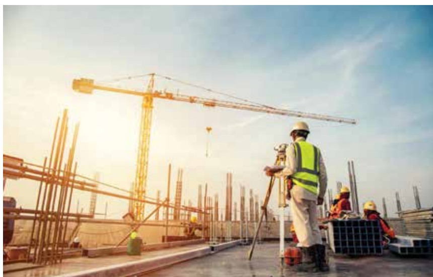
Standardiziranje postupanja javnih naručitelja, izvođača i kontrolnih tijela neophodno kako bi se izbjegli zastoji u radovima
