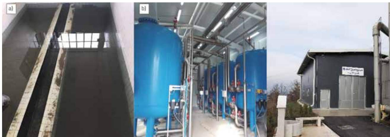
Slika 3. Filtri u sklopu postrojenja "Karašnica": a) gravitacijski filtar; b) filtri pod tlakom i građevina u kojem se nalaze
