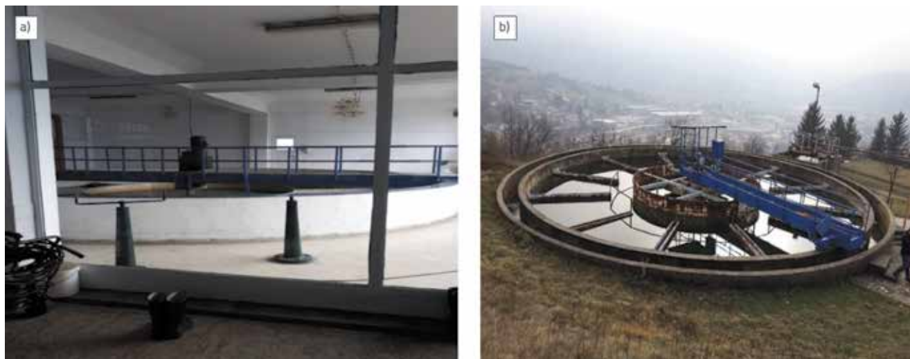
Slika 2. Kružni taložnici u sklopu postrojenja "Karašnica": a) Unutrašnji taložnik (T1) kapaciteta 50 l/s; b) Vanjski taložnik (T2) kapaciteta 100 l/s
