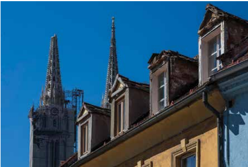
Oštećeni ili urušeni elementi potencijalno su opasni za stanare i prolaznike
