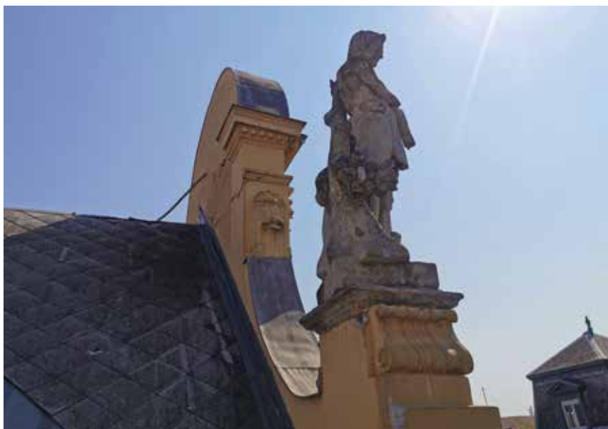
Zbog potresa je dio elemenata graditeljske baštine značajno oštećen
