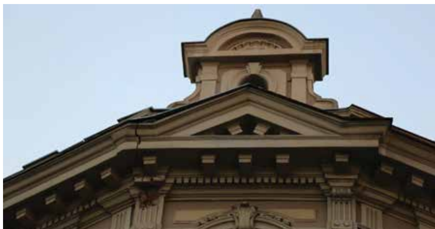
Većina povijesnih zgrada u središtu Zagreba nije projektirana na potresno opterećenje, pa su u potresu značajno oštećene
