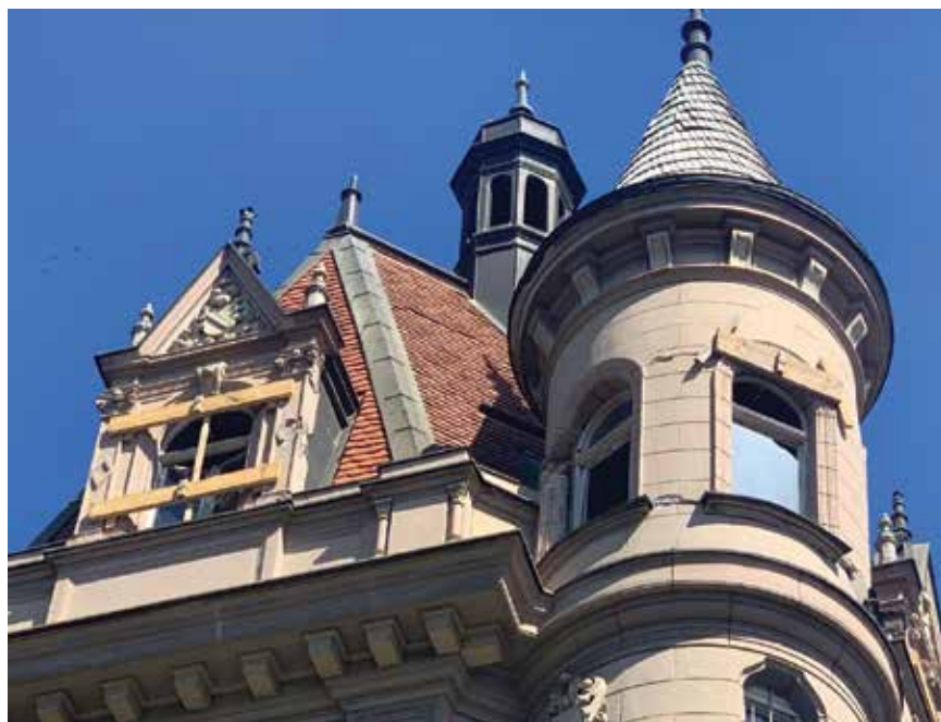
Pogled na oštećeni toranj i kupolu na raskrižju Jurišićeve i Kurelčeve ulice
