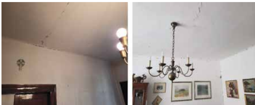
Slika 24. Pukotine na stropovima [39]
