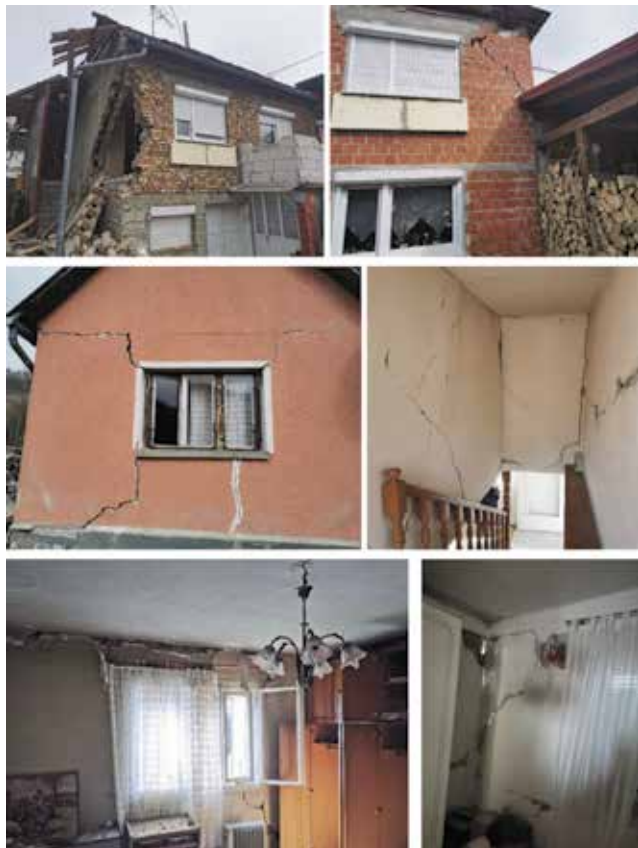
Slika 28. Oštećenja kuća u MO Vidovec, GČ Podsljeme (autor fotografija: Luka Božić i [39])
