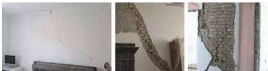
Slika 22. Dijagonalne pukotine u nosivim zidovima [39]
