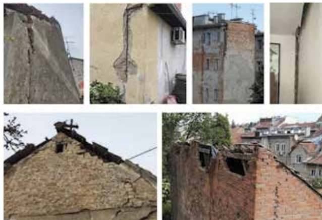
Slika 19. Odvajanje zabatnoga zida i karakteristične pukotine u unutarnjem dijelu zgrade (autor fotografija: Mario Todorčić [39])
