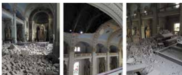
Slika 33. Prikaz oštećenja u bazilici Presvetog Srca Isusova (autor fotografija: Ivan Ćurić)
