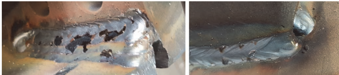
Pogreške u zavarima
