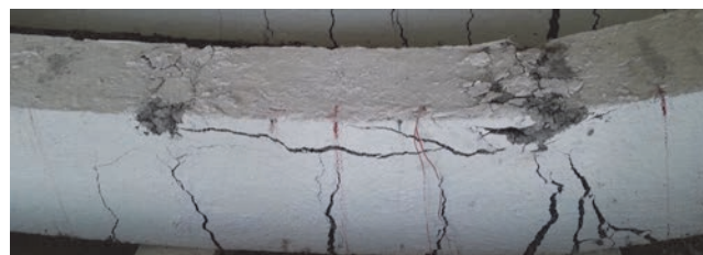
Slika 16. Oblik pukotina i vrsta loma armiranobetonske grede s dodatkom 20 % bakrene zguře i 0,4 % PP vlakana
