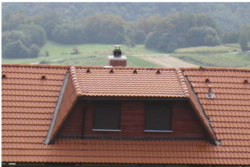
Loše oblikovan krovni prozor
