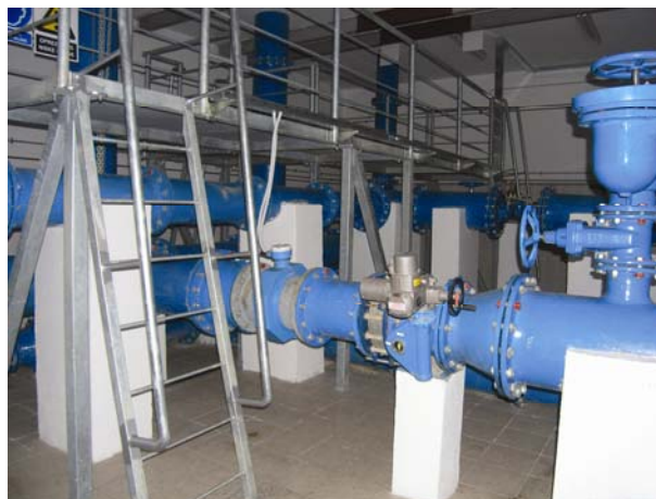
Slika 13. Postrojenje u novoizgrađenom vodospremniku Banov Stol
