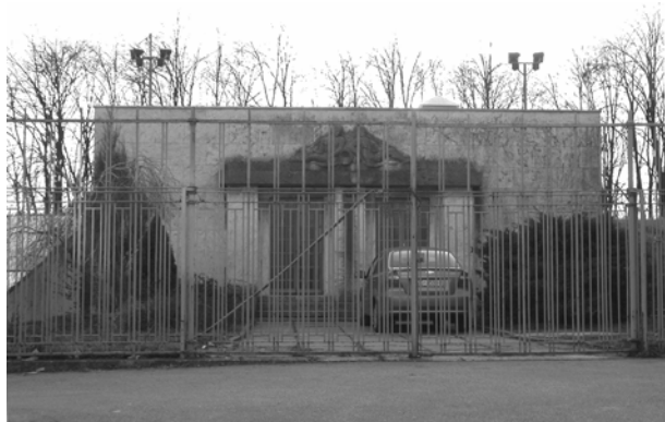
Slika 4. Ulaz i potporni zid rezervoara na Jordanovcu arhitekta J. Denzlera iz 1932. godine
