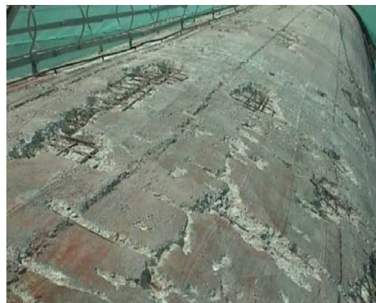
Slika 1. Izgled površine betona dimnjaka nakon odbijanja betona i pranja vodenim mlazom pod tlakom od 40 MPa
