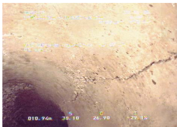
Slika 4. Pukotina na stijenci cijevi
