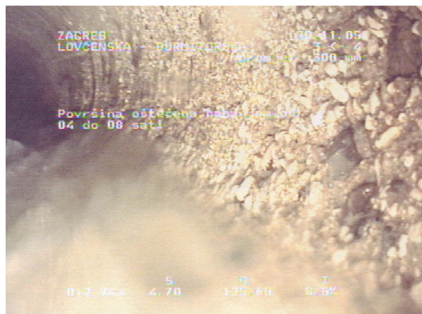
Slika 6. Infiltracija vode u kanal
