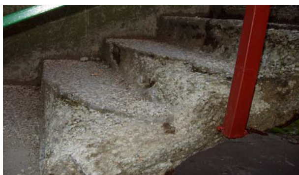
Slika 6. Primjeri oštećenja smrzavanjem
