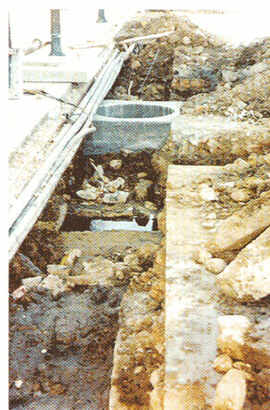
Zatrpavanje kanalizacijskog kanala
