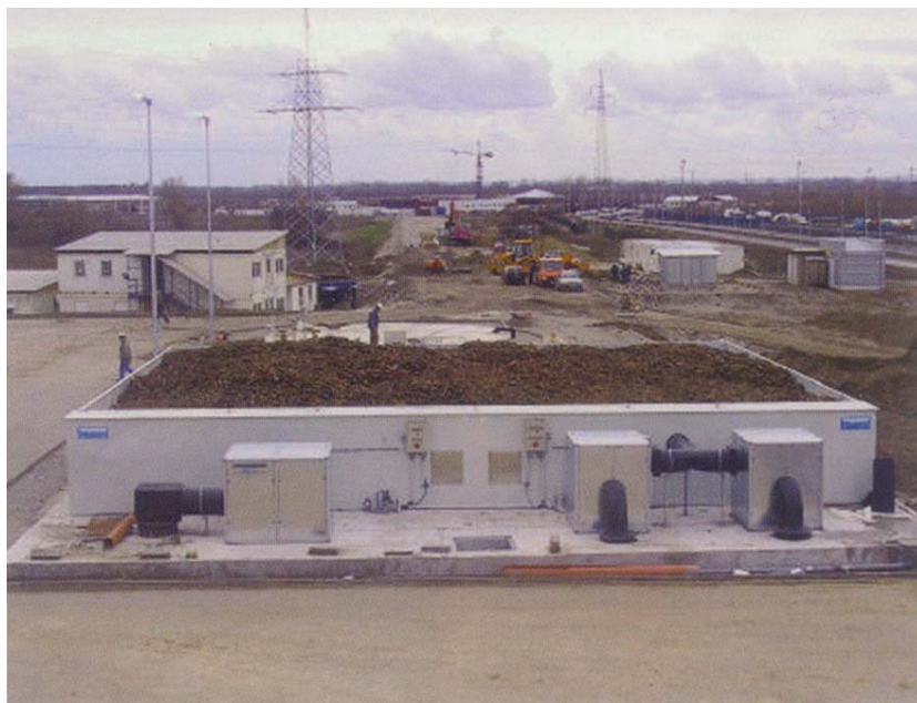
Biološko pročišćavanje zraka
