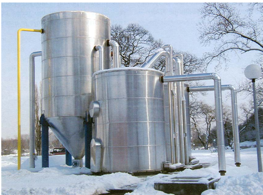
Blok uređaja za pročišćavanje u probnom radu
