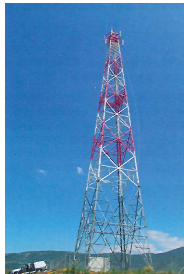
Čelični rešetkasti stup kao VIPnetova samostojeća stanica
